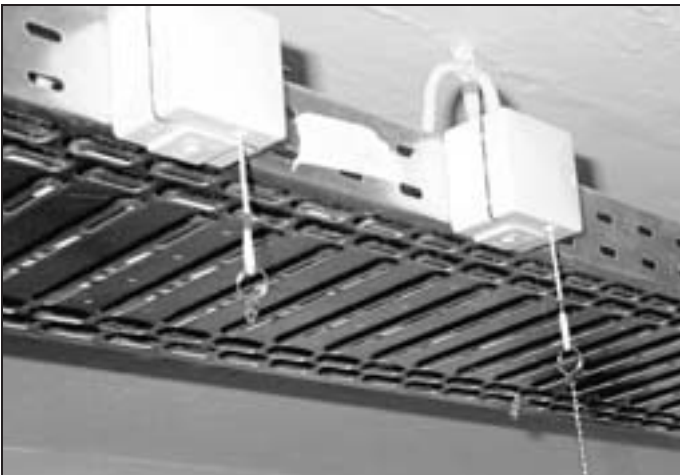
Strom, Computer, Telefon – alle Anschlüsse laufen in Kabelpritschen durch die Räume. Die kleinen Stripschen dienen als Lichtschalter.
