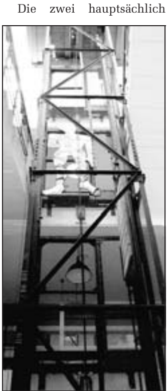
Der stillgelegte Lastenaufzug erinnert an längst vergangene Zeiten.
